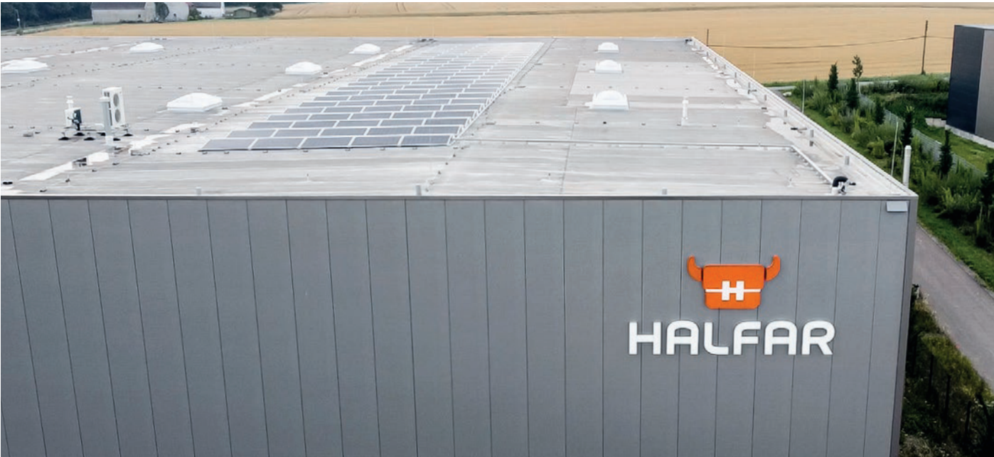
Logistikzentrum/Bielefeld Altenhagen – PV-Anlage auf dem Dach
